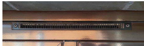
Entrée d'air pour VMC par extraction
